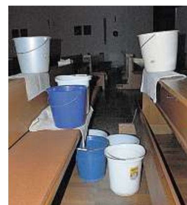
Bei Dauerregen oder Schneeschmelze dringt in die Kirche immer öfter Wasser ein. Fotos: Rieke (3)
